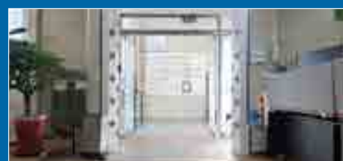
AIRMAX空气窗帘 安装在门口的两侧通过强力排放空气，阻隔外部空气流动，防止细尘及有害细菌的流入
